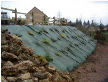
Bâches plastiques à éviter
